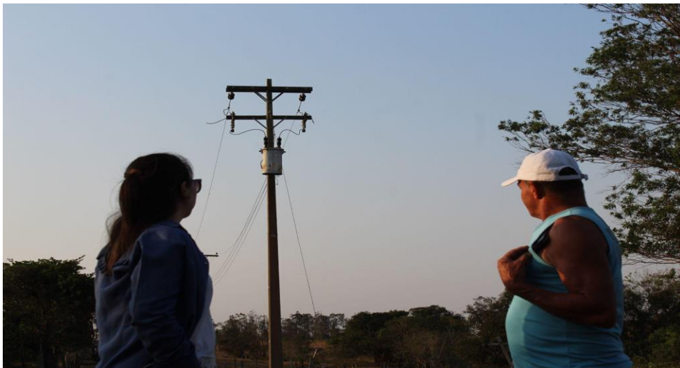
Imagem 42 – Instalação elétrica recém-construída. Fonte: Arquivo pessoal da autora, 10/09/22
